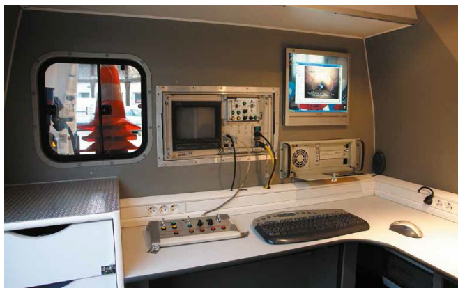
Poste de contrôle de caméras.
