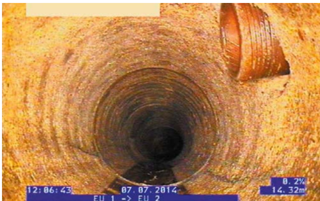
Raccordement mal effectué.
