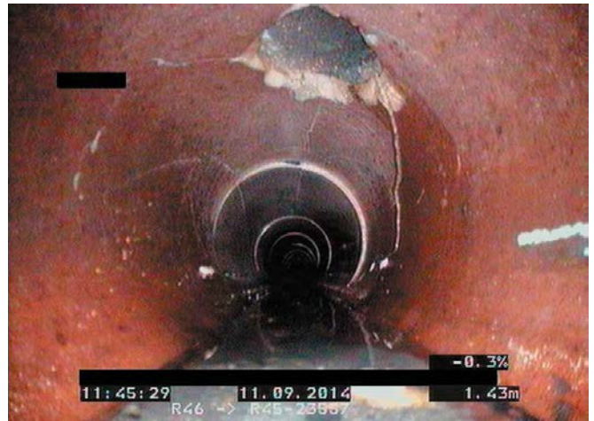
Fissures autour d'un embranchement.
