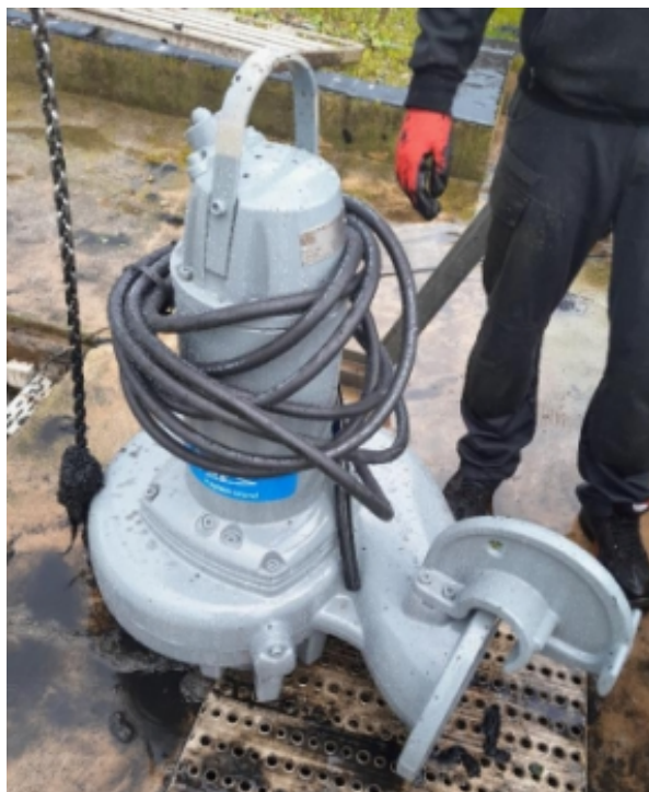
Pompe recirculation n°4 après renouvellement STEP St Cyprien
