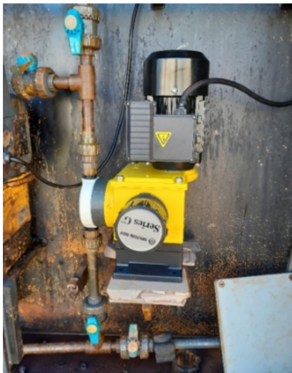
Pompe FeCl3 n° renouvelée STEP Corneilla
